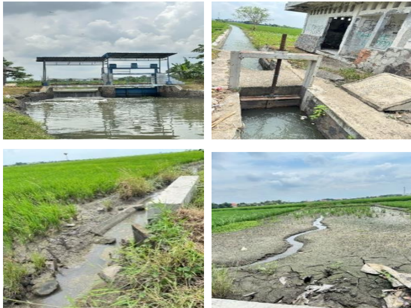
Gambar 4. Kondisi Salah Satu Irigasi Di Desa Wilayut Sumber: Dokumentasi Penulis (2024)
