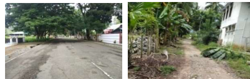
Gambar 3. Kondisi Jalan Kerikil dan Jalan Aspal
